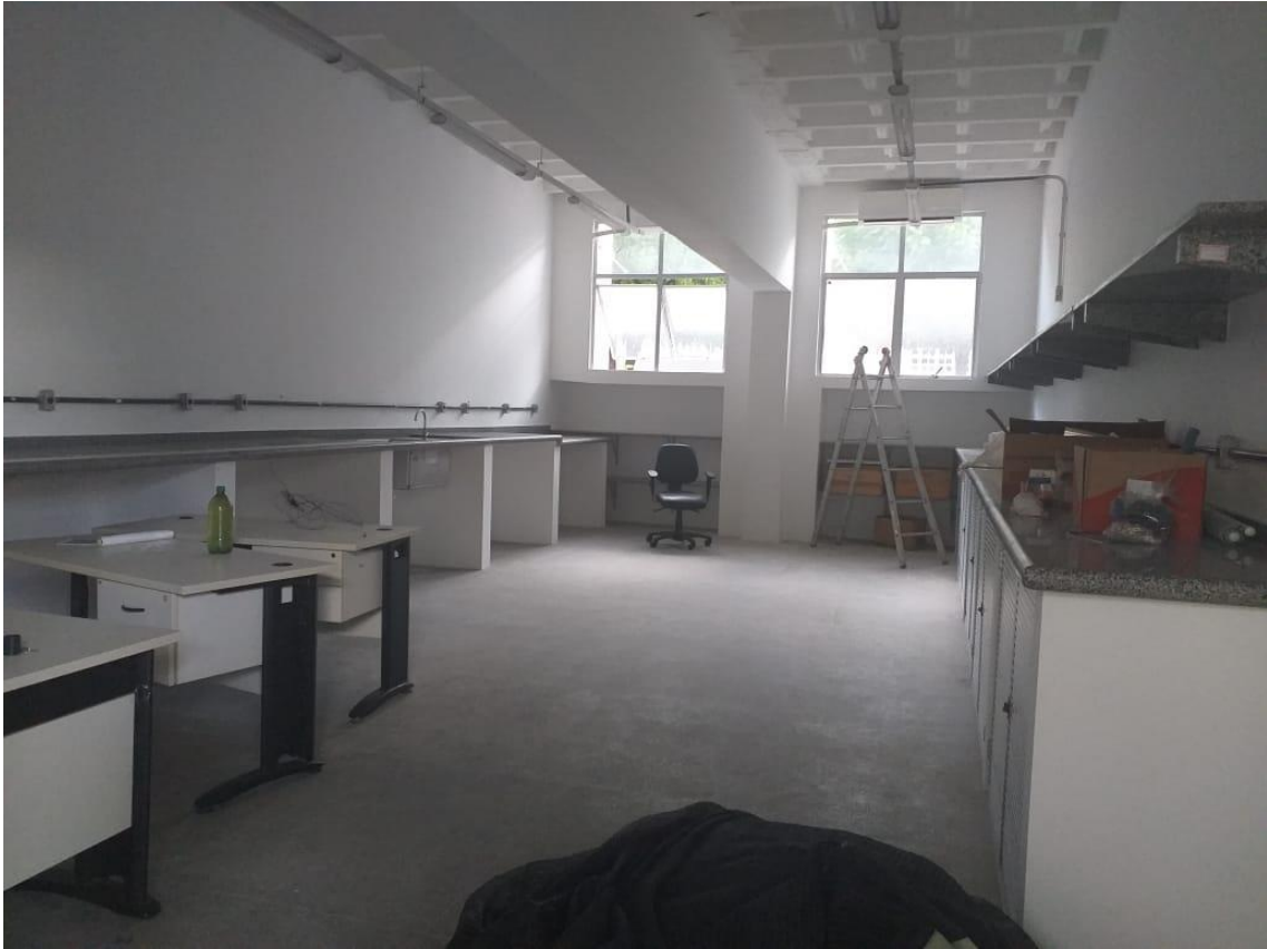
Figura 3. Construção das bancadas e das instalações elétricas e hidráulicas do laboratório de Apicultura e Análise de mel.
