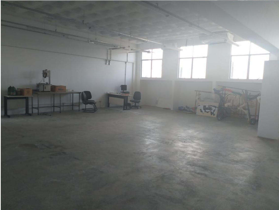
Figura 2. Construção das bancadas e das instalações elétricas e hidráulicas do laboratório de Fisiologia e Anatomia Animal.
