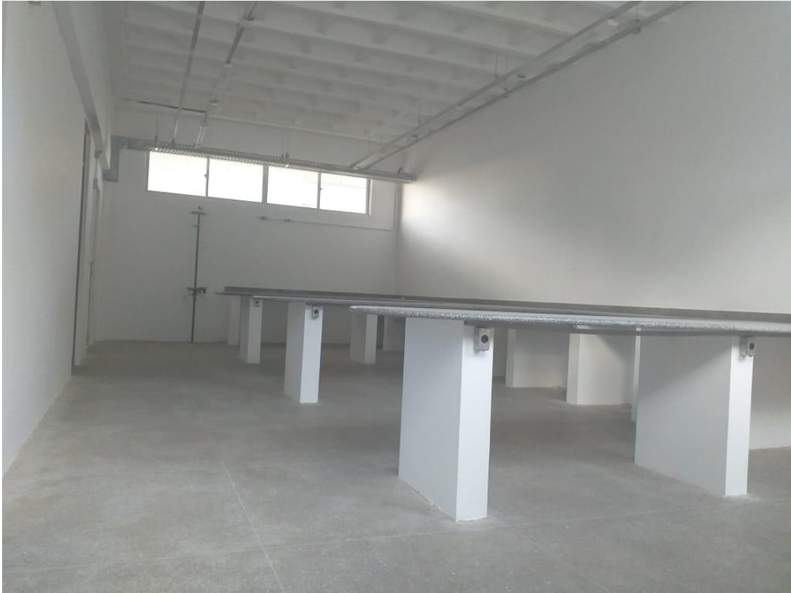
Figura 5. Construção das bancadas e das instalações elétricas e hidráulicas do laboratório de Química e fertilidade do Solo.
