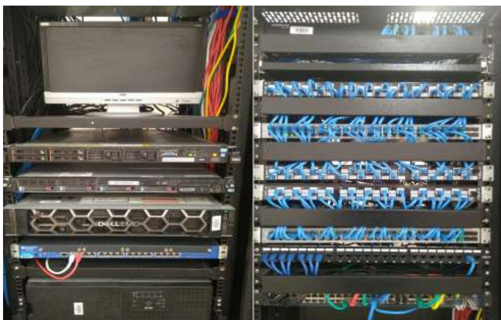
Figura 9 - Servidores e equipamentos diversos.
